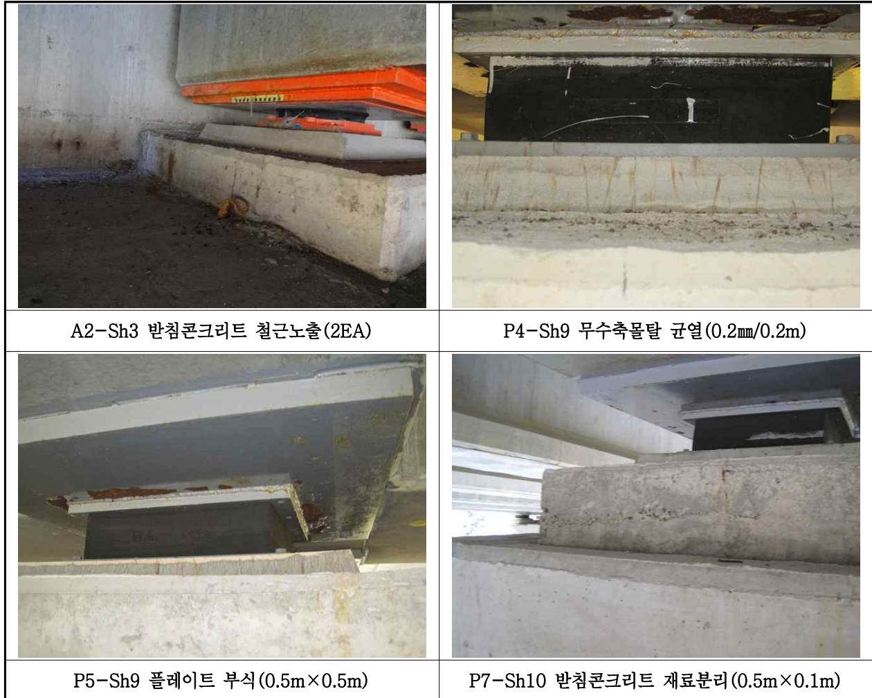
【사진 10.3.13】 교량받침 손상현황
