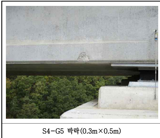
【사진 10.3.28】 거더 손상현황
