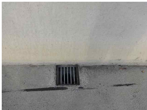
S8 그레이팅 파손
