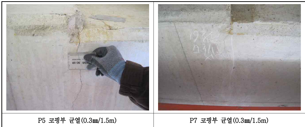
【사진 10.3.34】 교각 손상현황
