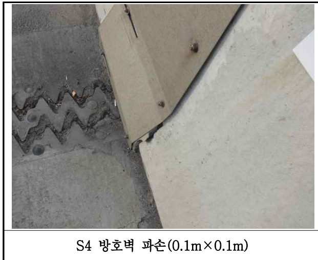
【사진 10.3.24】 방호벽 및 중앙분리대 손상현황
